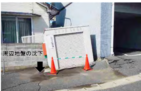
写真2(a) 宅地地盤の沈下
