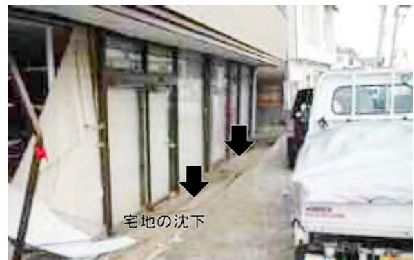
写真2(b) 宅地の沈下による道路との段差
