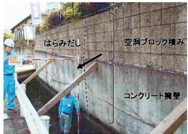
写真1(b) 増し積み擁壁境界部のはらみだし
