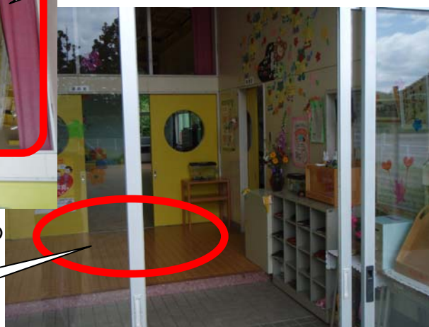
写真 1.2.2 割れたガラス下の床(ガラス片撤去後)
