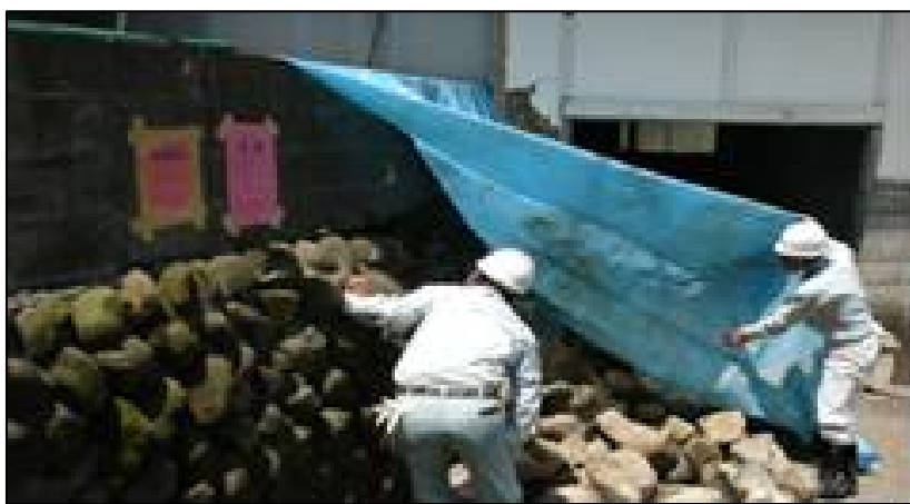
写真 10.3.2 判定活動（玉石積みの崩壊）
