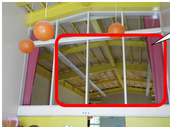
写真 1.2.1 3枚のガラスが割れたあとの はめ込みガラス枠
