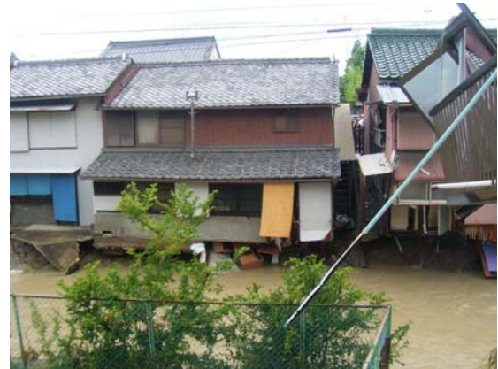
写真 5. 1. 2 行方不明者が発生した民家 （濁流により1階床部分が崩落）
