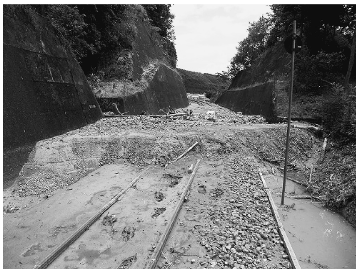
写真 2-1-2 土砂で不通になった線路
