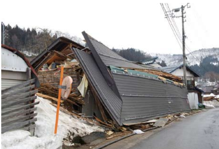
写真1 2階部分が押しつぶされ、屋根が道路側に崩落した公民館
