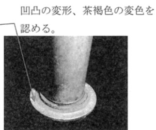
写真7 メイン接点を見る
