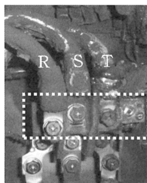
写真4 破線内がサーマルリレー
