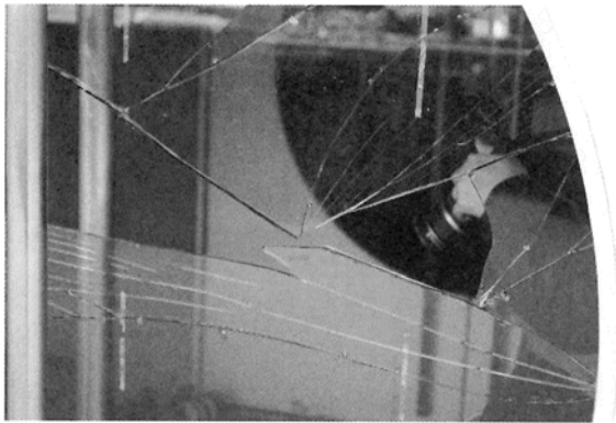
図4 空振で割れた霧島市霧島支所の窓ガラス (坂之上浩幸氏撮影)
