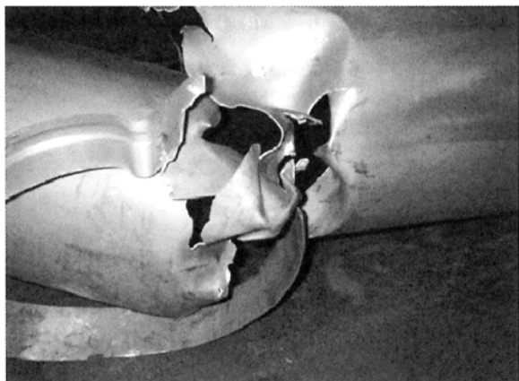
図 1 フロートチューブの破断状況
