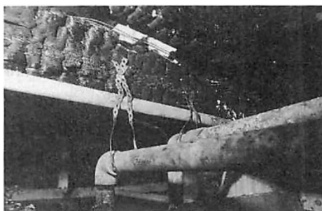
①出火部（天井裏）の状況
