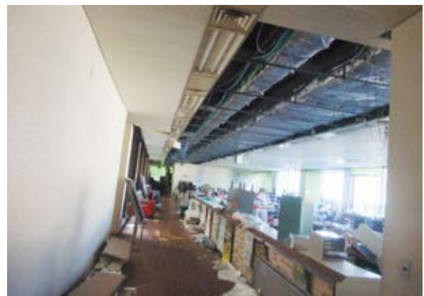
崩落した庁舎1階天井
