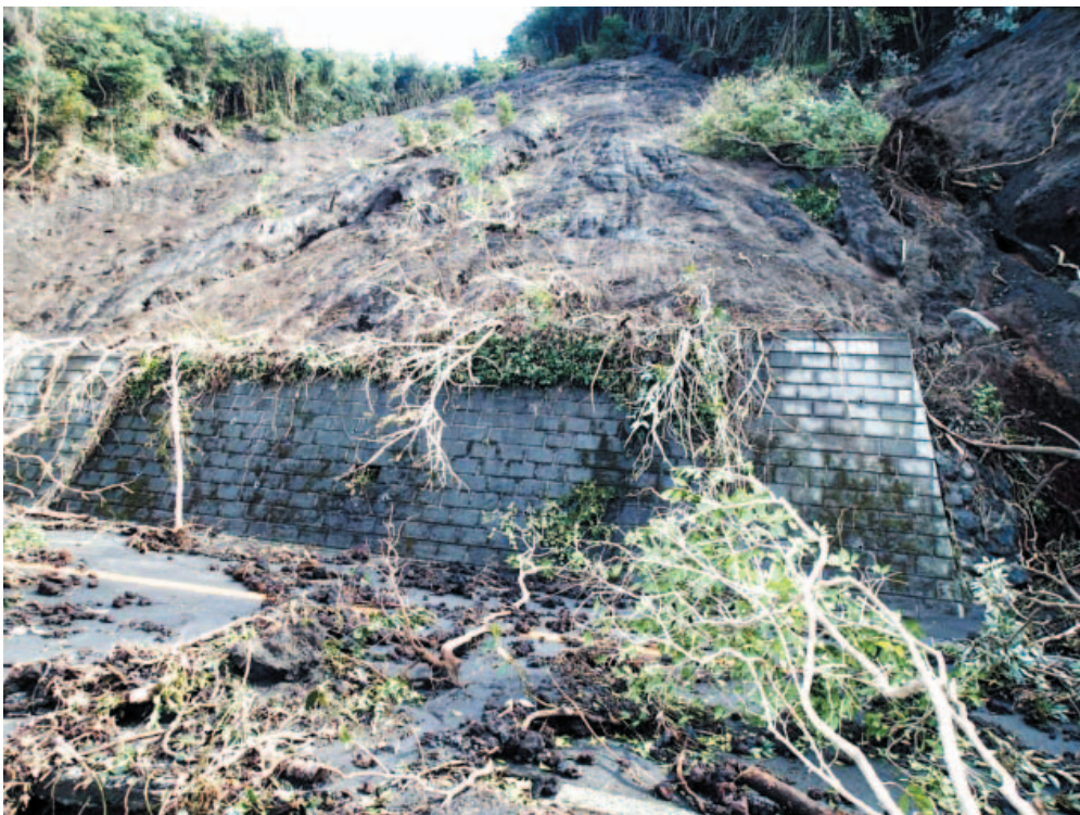
図4 崩壊発生源の一つ
