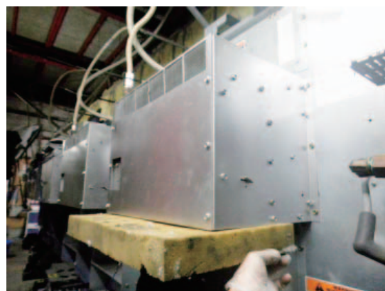
写真15 下のみ排気不良の再現
