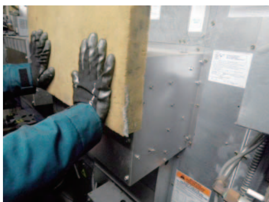
写真14 上のみ排気不良の再現
