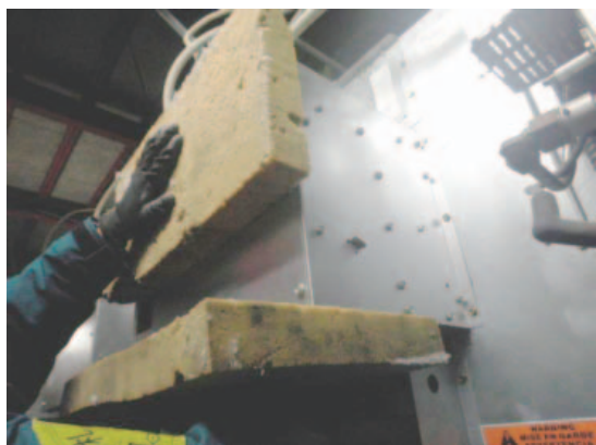
写真13 上下排気不良の再現
