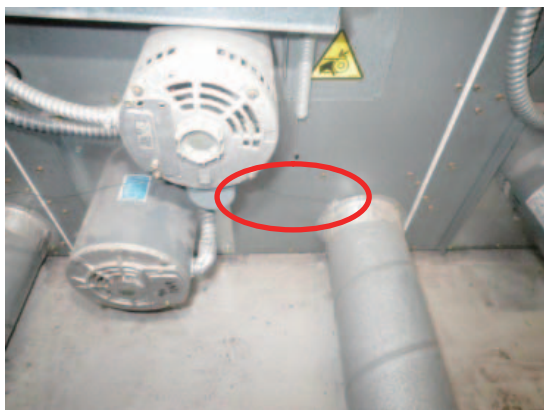
写真10 排気室リミットサーモ及びサーミスタの熱電対
