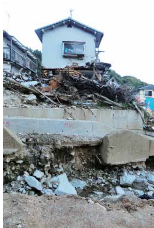
写真3 浸食された谷壁に過去の土石流堆積物が見られる。過去にも土石流が発生していたことを示す。
