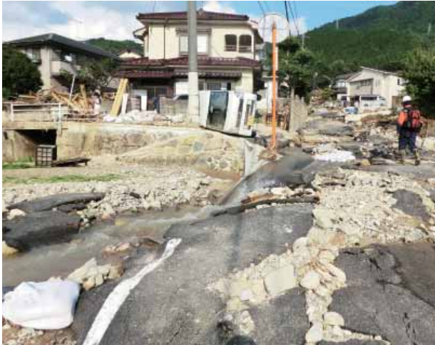
写真8b 水路が堰き止められたことにより流路となった道路。水の作用によりアスファルトが削剥されている。
