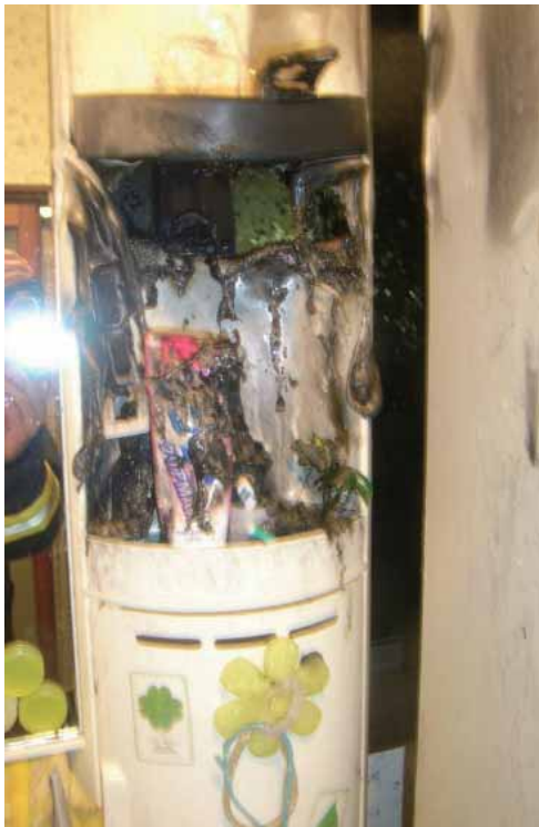
写真 トレー部分の焼損状況
