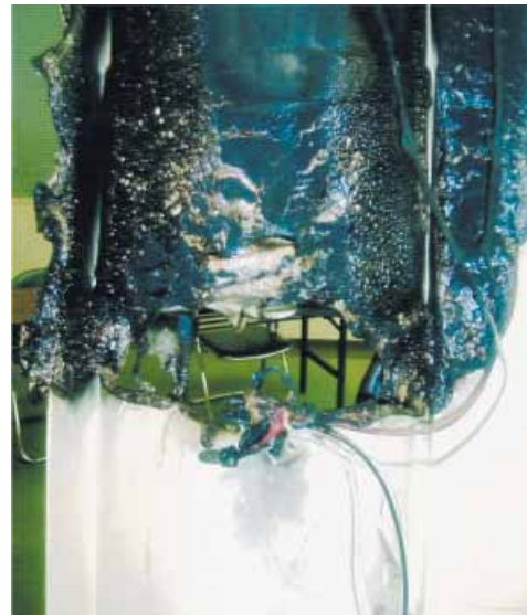
写真 トレー部分の焼け抜け箇所
