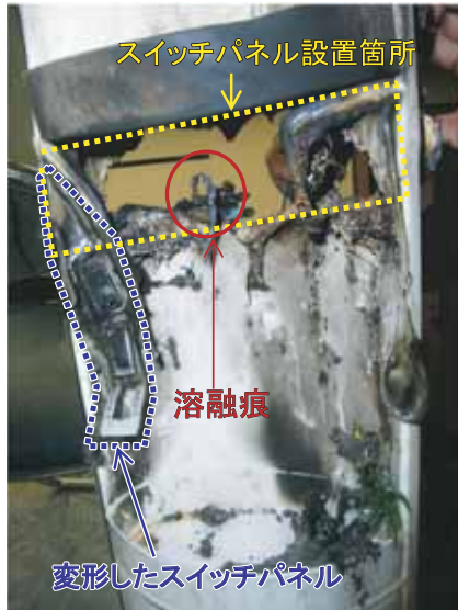
写真 トレー部分の焼け抜け箇所
