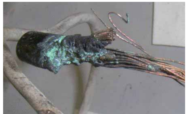
写真 閉端接続子CE - 5 (4本)の配線接続部
