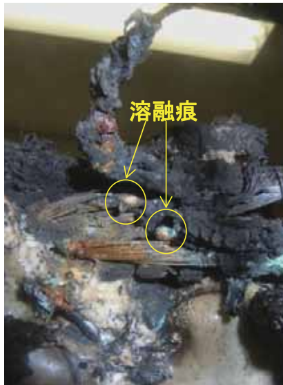
写真 トレー部分の配線の熔融痕
