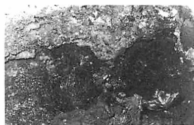
堆積した塗料カス層
