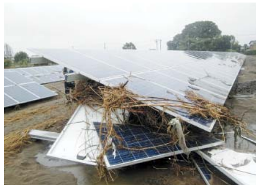
図7 現場付近の太陽光発電機器の被害
