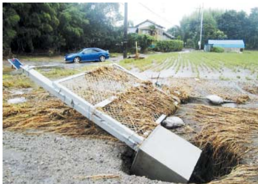
図6 現場付近における塀の被害
