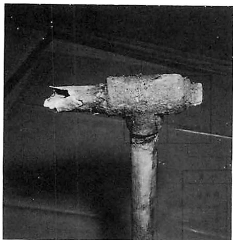
写真1 床下ガス配管の腐食部分
