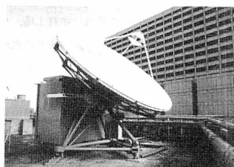
消防庁(人事院ビル)の屋上に設置されたパラボラアンテナ
