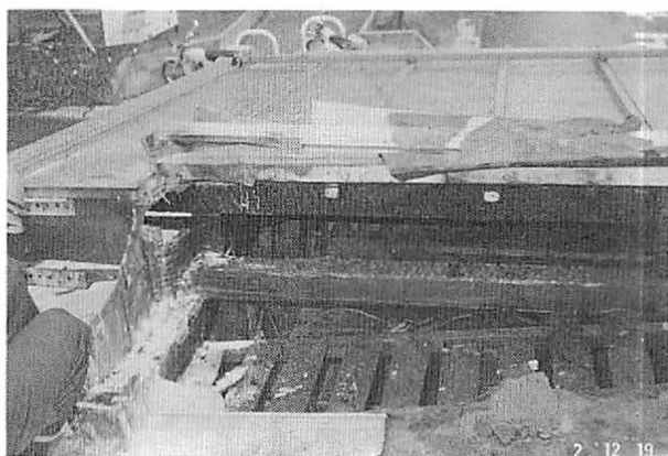
写真1 出火箇所の屋根裏
