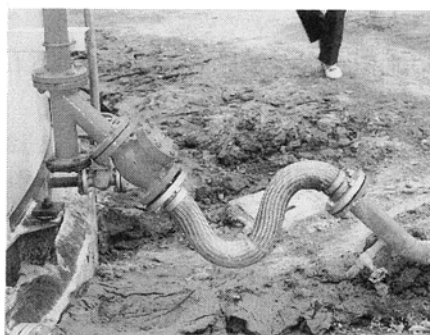
写真12 タンクの沈下により曲がったフレキシブルホース
