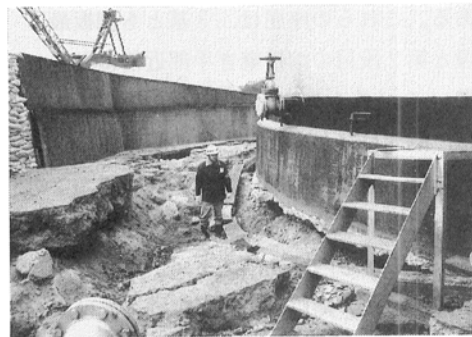
写真7 液状化による地盤の崩壊 ( V = 3,000 \text{ kl} , D = 17.4 \text{ m} , H = 13.7 \text{ m} )
