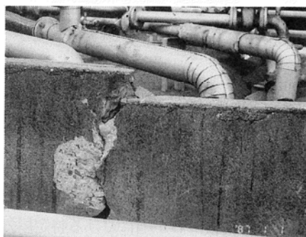
写真11 コンクリートのき裂により上下に食い違いが生じた防油堤
