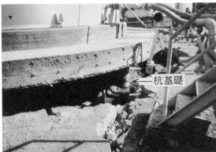
写真6 液状化による杭基礎の露出 ( V = 596 \text{ kl} )
