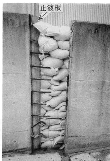
写真10 土のうが積まれた防油堤目地部の開口
