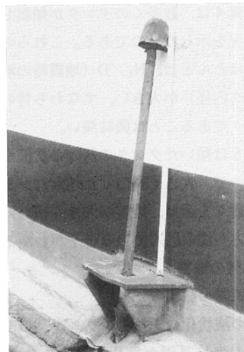
写真9 アンカーボルトの引き抜け（水タンク） (引き抜け量：約55cm)
