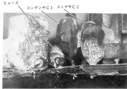
写真3 基盤焼失箇所の状況
