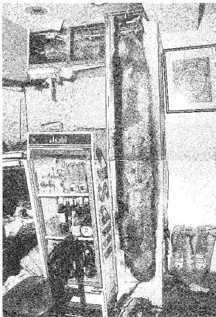
写真 3—3 垂直ダクトの焼損状況
