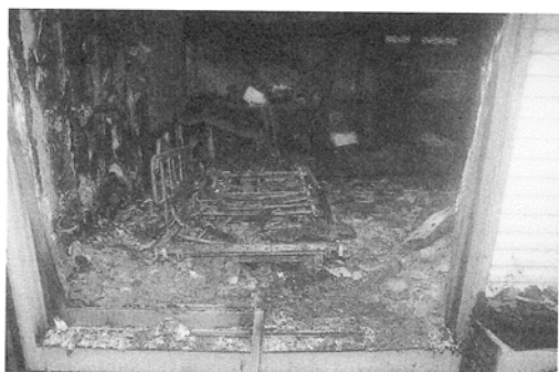
写真2 出火室の状況
