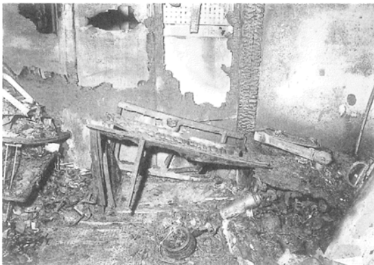
写真1 出火部位の状況
