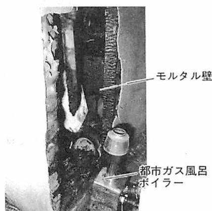
写真1 出火箇所の焼き状況
