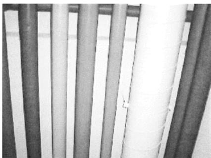
写真4 色分けされた配管
