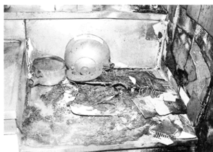
写真1 出火箇所付近の状況
