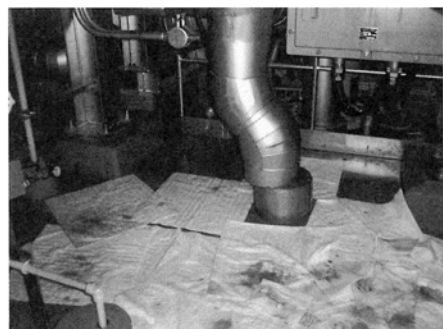
写真2 床の絶縁油を吸取紙に染み込ませた状況
