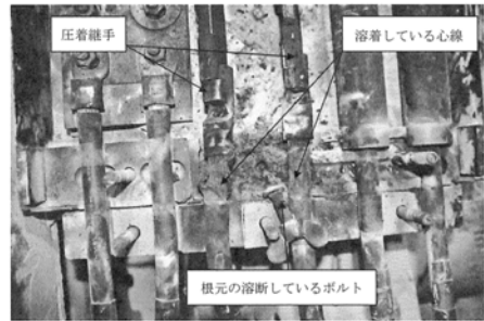
写真8 ツナギ箱内の焼損状況 （絶縁筒を除去）
