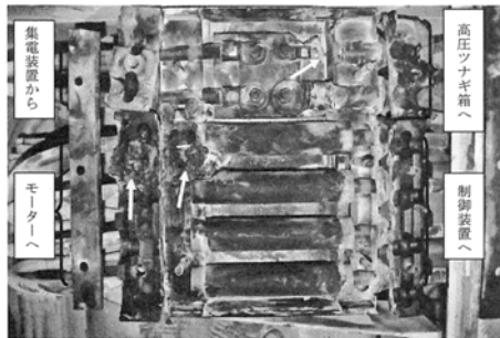
写真6 ツナギ箱内の焼損状況
