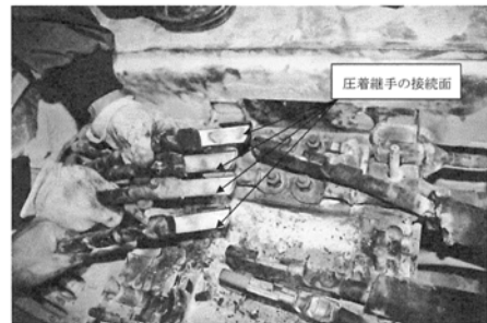
写真9 圧着継手の状況
