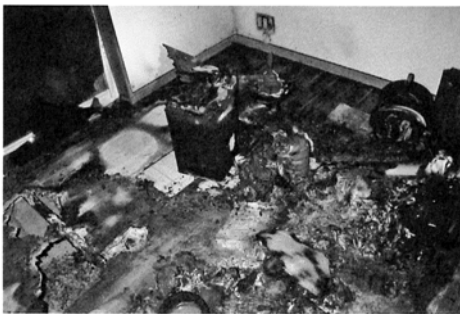
床の焼損状況
