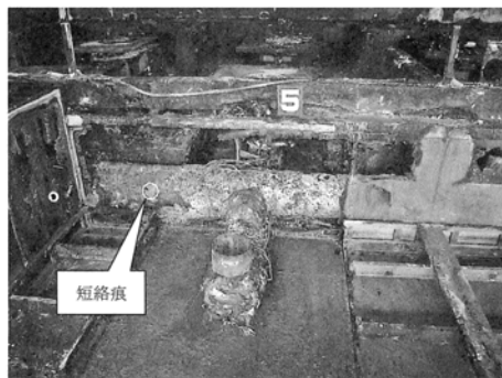
写真11 5番テーブル横の排気ダクト
