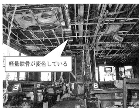
写真2 客室天井の焼損状況
