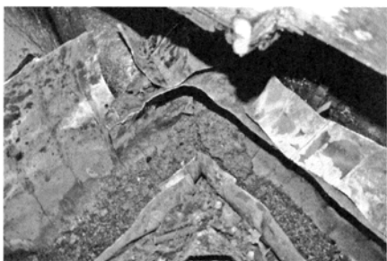
写真13 5番テーブル付近の 排気ダクト内の油塵
