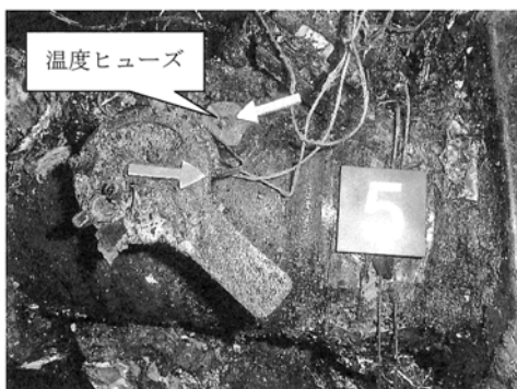
写真8 5番テーブルの防火ダンパー
