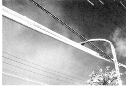
写真2 配電線への着雪(長野県軽井沢町)
