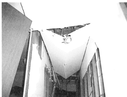
廊下天井の破損状況
