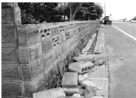
崩れたブロック塀（栗原市内）
