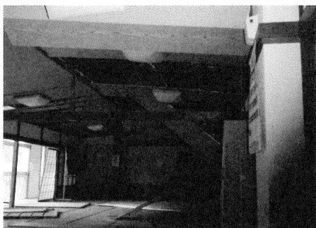
被害を受けた公民館（奥州市内）
