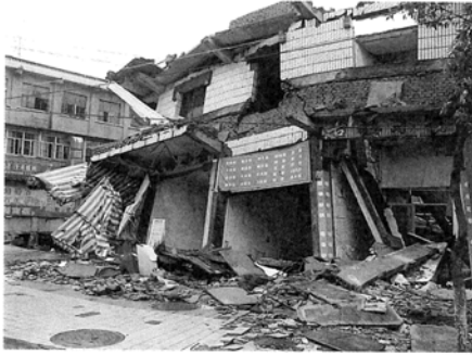
写真1 漢旺鎮での建物被害
