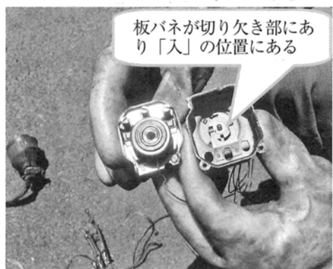
写真 3 ダイヤル式スイッチ内部の状況
