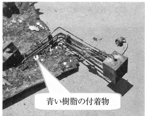
写真 2 焼損した投込み型電熱ヒーター
