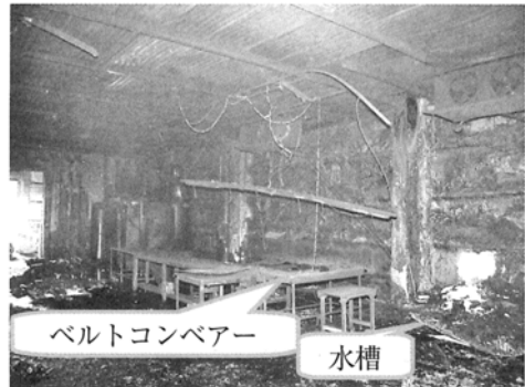
写真 1 B庫内の焼き状況
