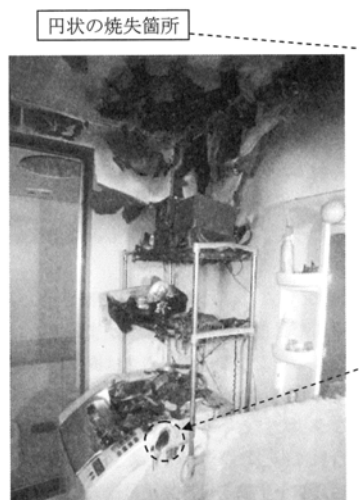
写真 1 出火室内北西角付近
