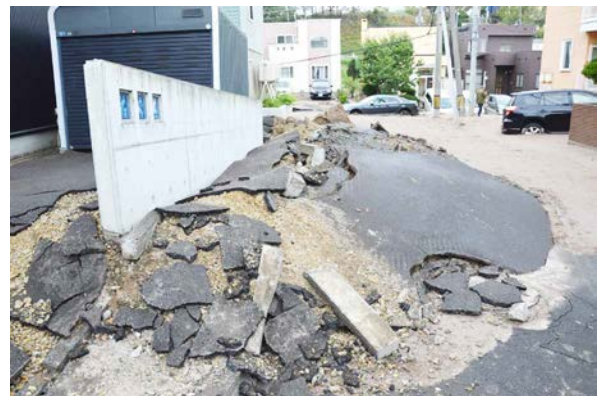
写真-6 被災地の状況（地点 e）
