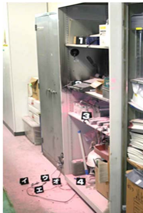
【写真1 焼損したキャビネット付近の状況】
