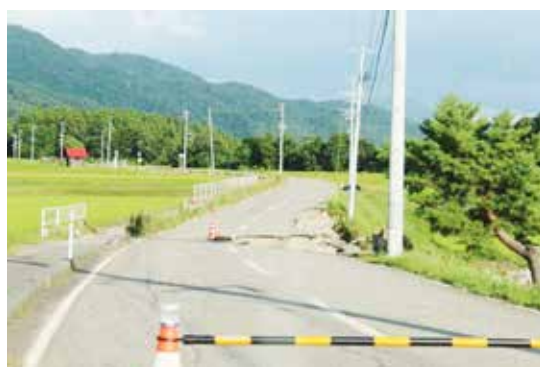
図5 陥没した道路（湯沢地区）
