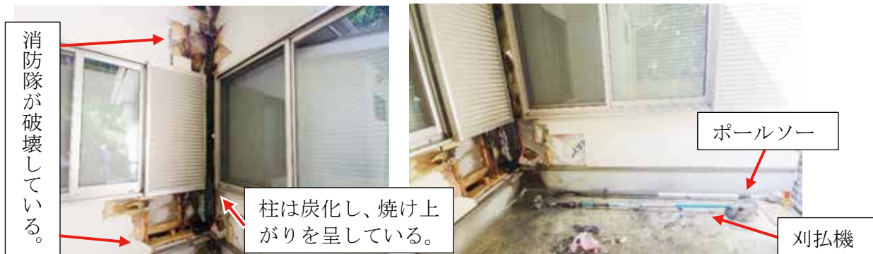
【写真1 外壁の焼損状況】
