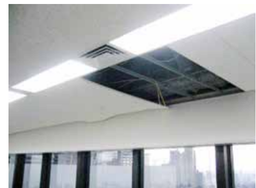
写真8 超高層建築の高層階での吊り天井板の落下（2011年東日本大震災）
