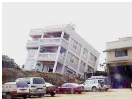
写真10 大規模な縦ずれ断層変位で傾斜したRC造住宅（後に修復、1999年台湾・集集地震）
