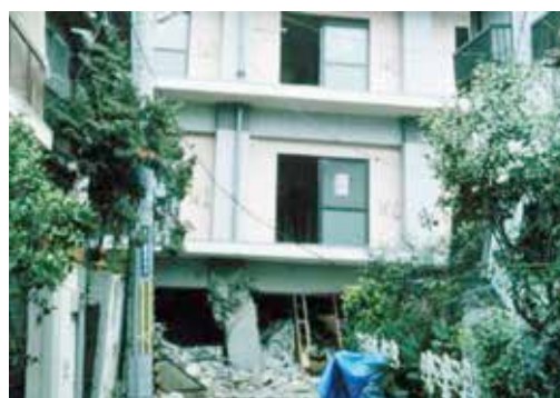
写真2 1階ピロティ柱が破壊した4階建てRC造集合住宅 (阪神・淡路大震災)
