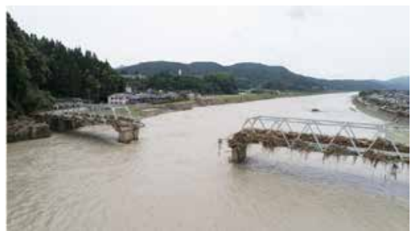
流出した西瀬橋（人吉市）
