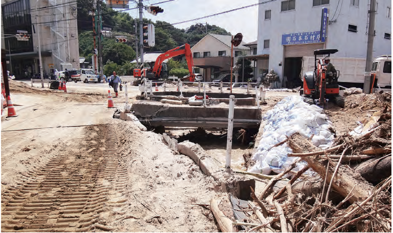
広島市安佐北区：河川に堆積した瓦礫、破壊された護岸 (2018年 7 月13日撮影)
