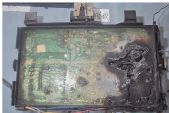
写真5：電装ケース及び制御基板の状況
