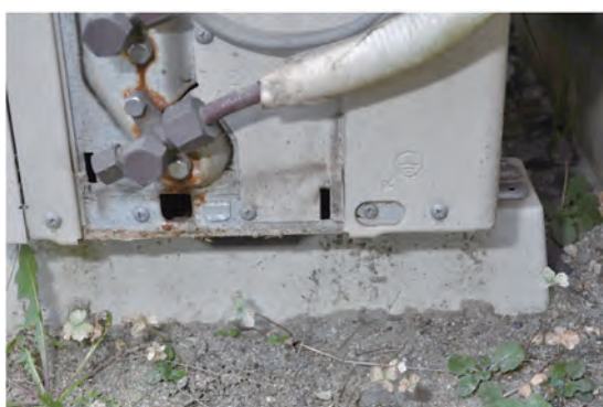
写真9：室外ユニット（アース端子）の状況
