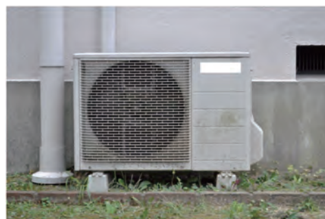
写真1：室外ユニットの設置状況
