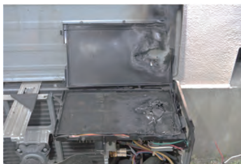
写真3：電装ケースの蓋部分を開いた状況
