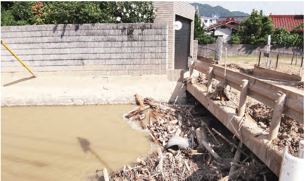
広島県府中町山田2丁目：橋梁に堰き止められた瓦礫 (2018年 7 月13日撮影)
