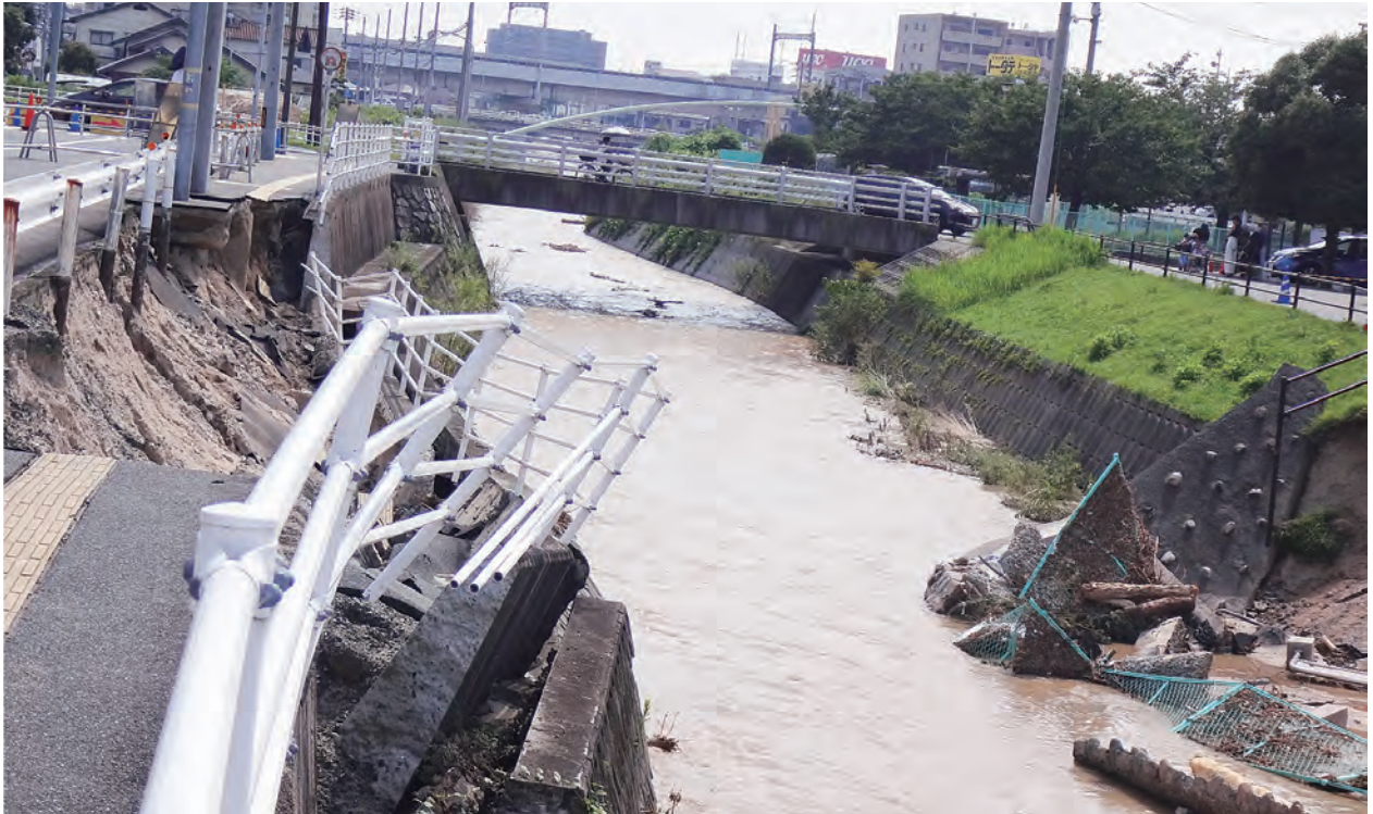
広島県府中町役場付近被災の様子：榎川護岸潜屈箇所下流側 (2018年 7 月13日撮影)
