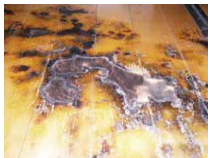
火災現場の床面の焼き状況
