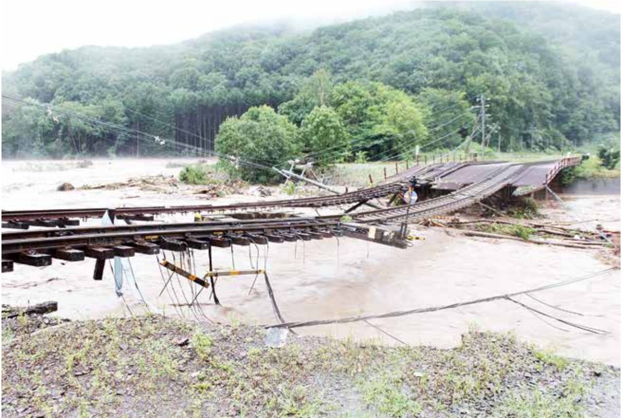
崩壊した線路鉄橋 2016年 8 月31日撮影（写真提供：北海道新得町）
