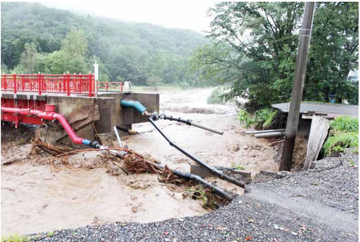
崩壊した神社橋 2016年 8 月31日撮影（写真提供：北海道新得町）
