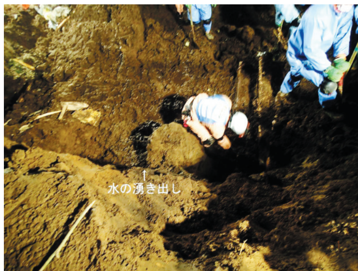
図6 掘削地点からの水の湧き出し状況
