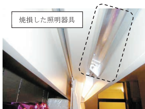
写真2 照明器具の取付状況
