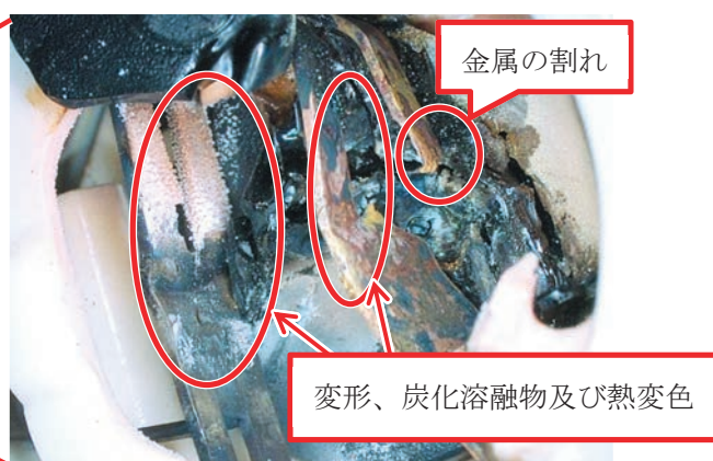
写真7 焼けているソケットの状況
