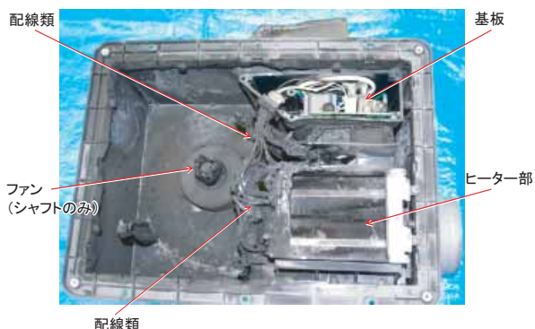
写真4 浴室暖房機内 (フロントパネルを取り外した状況)
