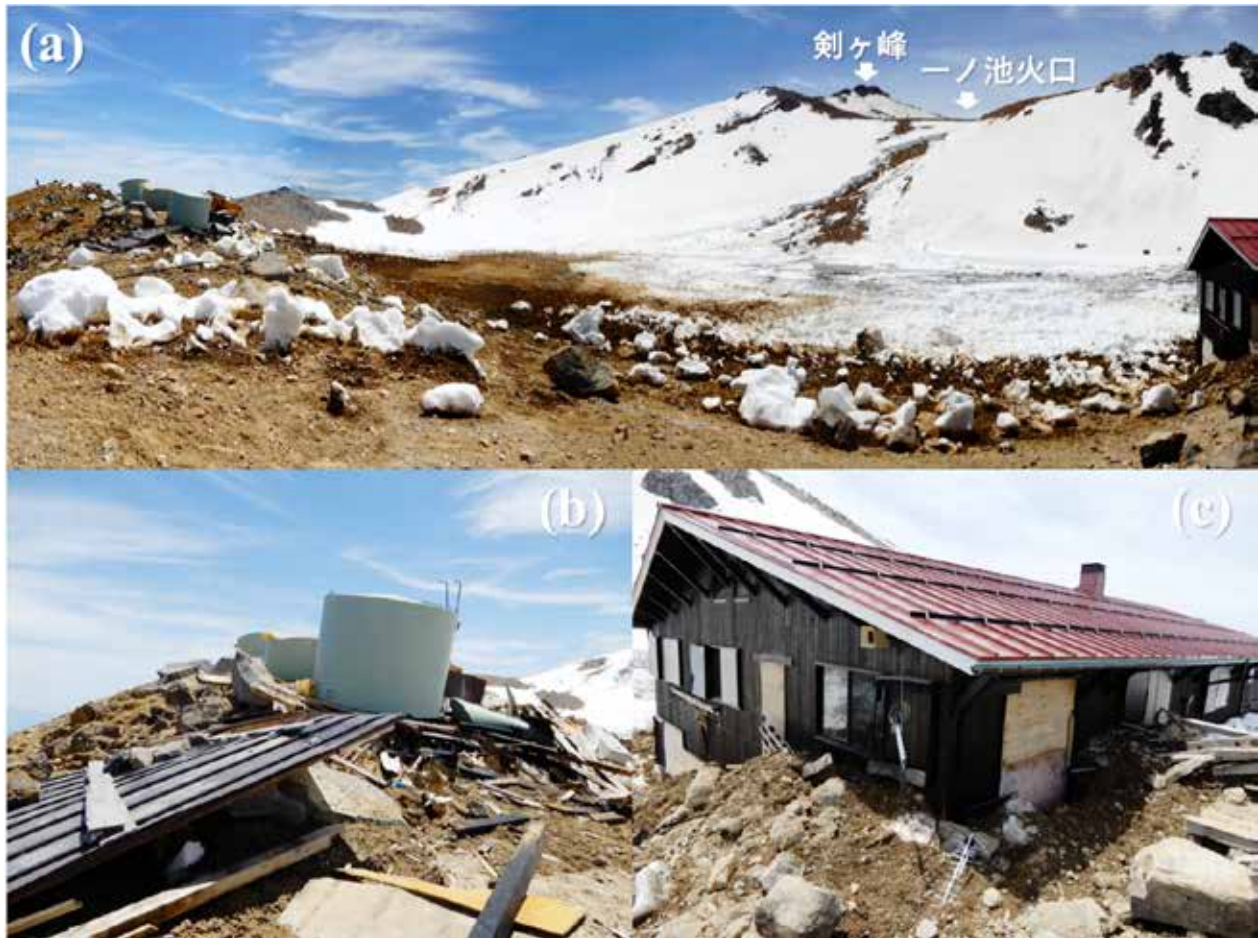
図4. 2019年5月21日に発生した雪崩と雪泥流 2019年5月27日撮影
