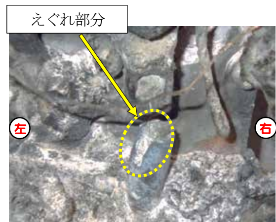
【写真14 ケーブルDの状況】
