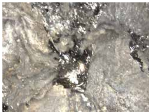
【写真30 写真29丸印の拡大状況】
