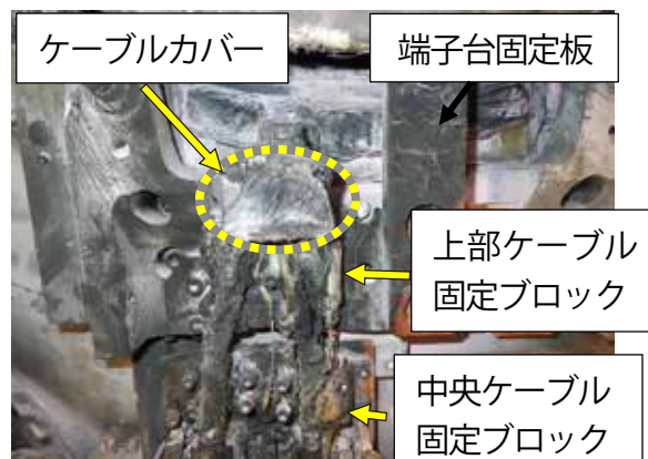
【写真8 端子台周囲の状況】
