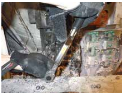
【写真10 端子台ボルトの状況】
