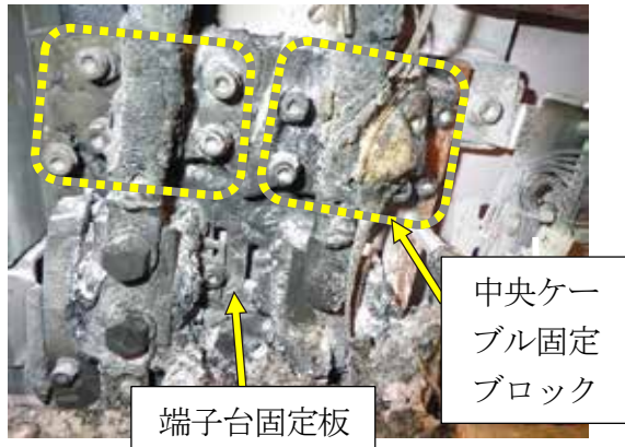
【写真9 端子台周囲の状況】
