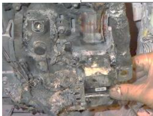
【写真16 端子台周囲の状況】
